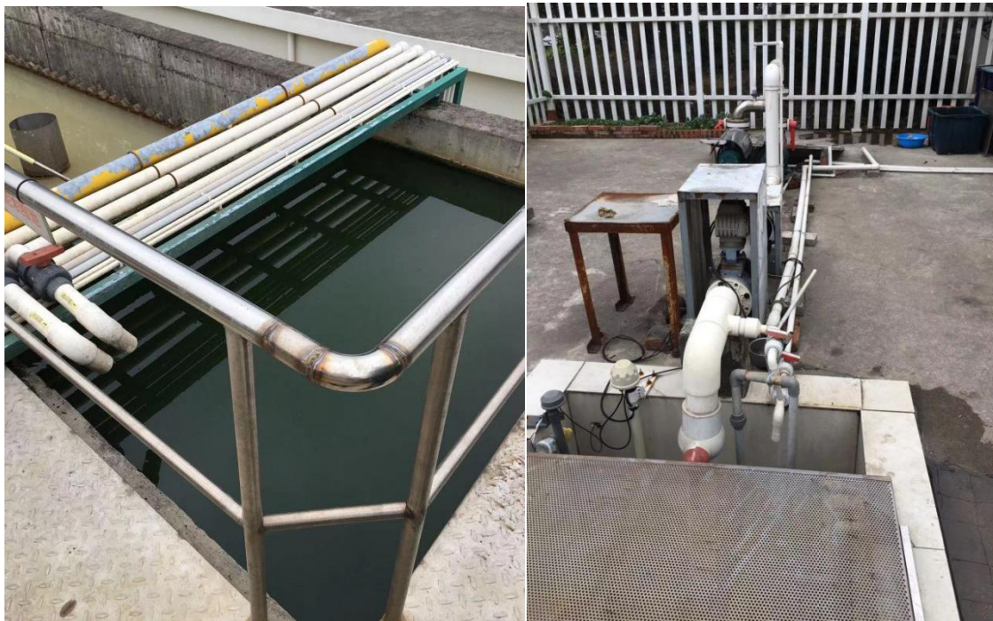
图 3-2 (左侧) pH 调节池; (右侧) 综合废水排放口
