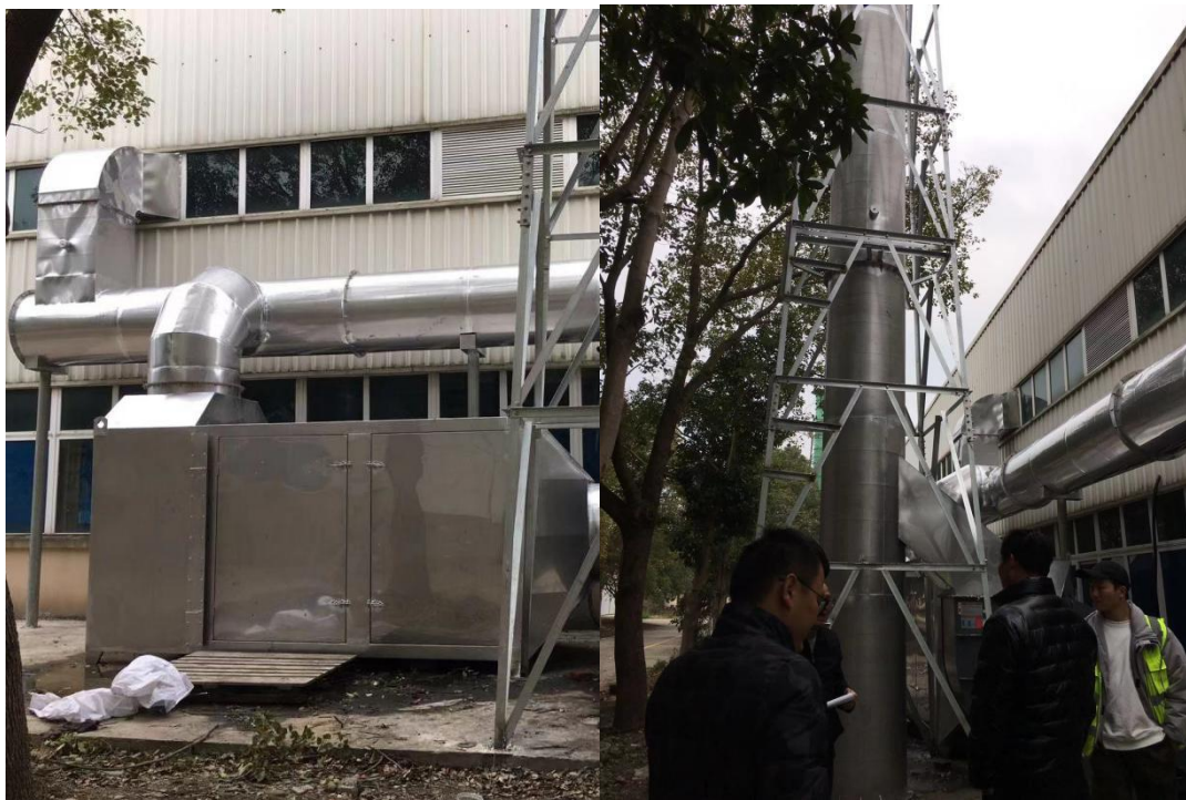
图 3-3 活性炭吸附处理装置，注塑排气筒
